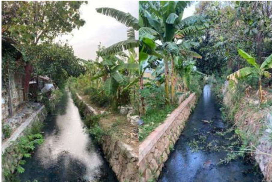
Gambar 1. Saluran akhir perumahan Graha Cikarang (kiri) dan perumahan Grenada Kluster (kanan) (dokumentasi Jannah dan Aulia, 2023).
